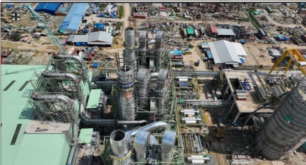
TOMATO FLASH DRYER DEWATERING - KALIMANTAN UTARA
