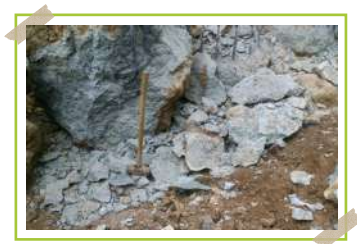
Hasil bobokan batu kali dibobok dengan ukuran kecil akan dibuang atau digunakan untuk perataan jalan proyek
