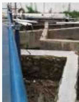
Instalasi Sediment Pond pada salah satu Proyek / Sediment Ponds Installation at one of Project
